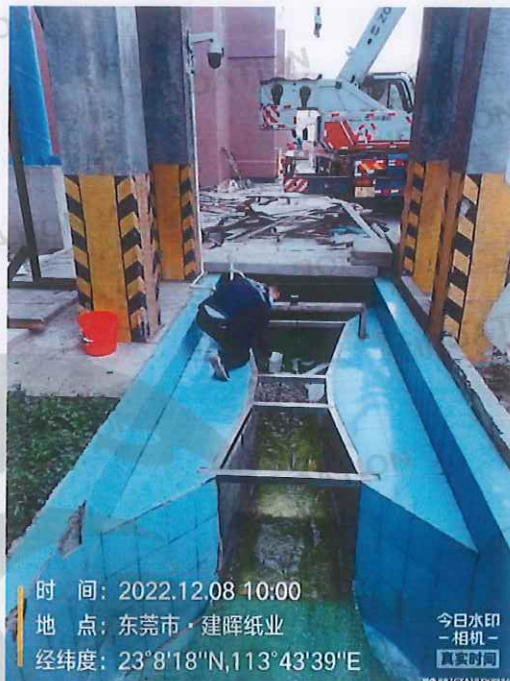
废水排放口 (DW001)
