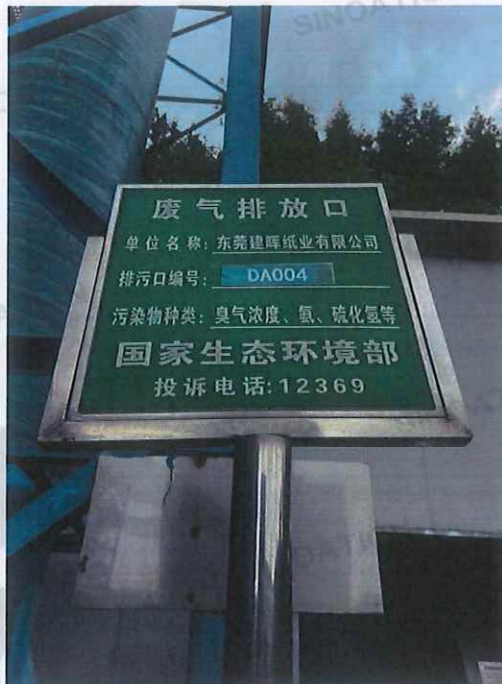
除臭系统废气排放口 FQ-00002 (DA004) 排污铭牌
