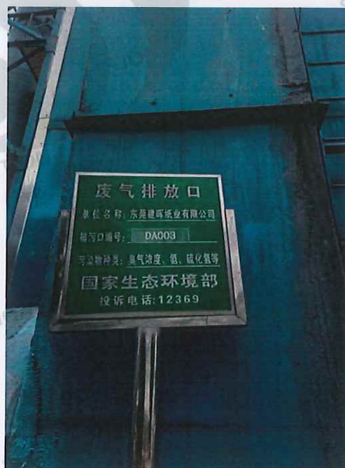
除臭系统废气排放口 FQ-00001 (DA003) 排污铭牌
