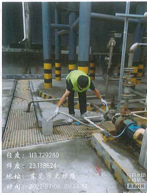
脱硫废水取水点
