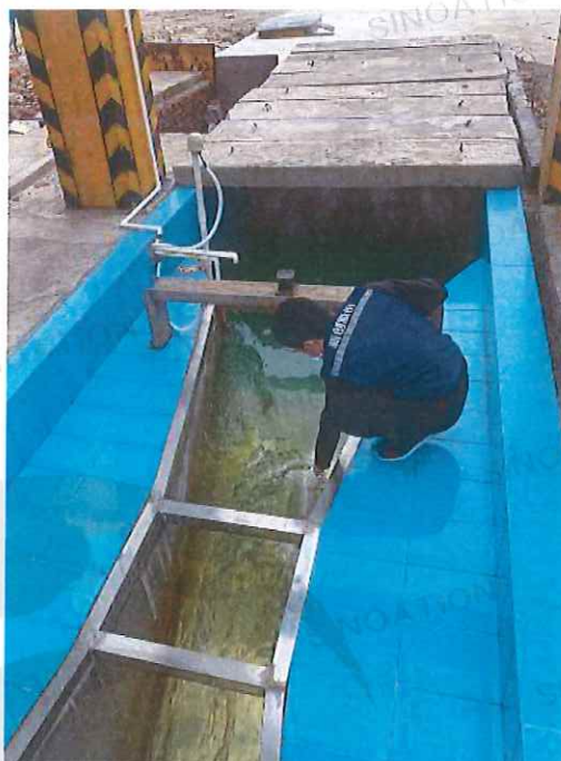
造纸废水排放口 (DW001)
