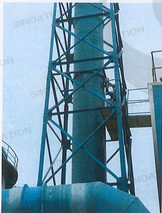
除臭系统废气排放口 FQ-00001 (DA003) 排污铭牌
