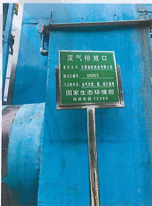
除臭系统废气排放口 FQ-00001 (DA003)
