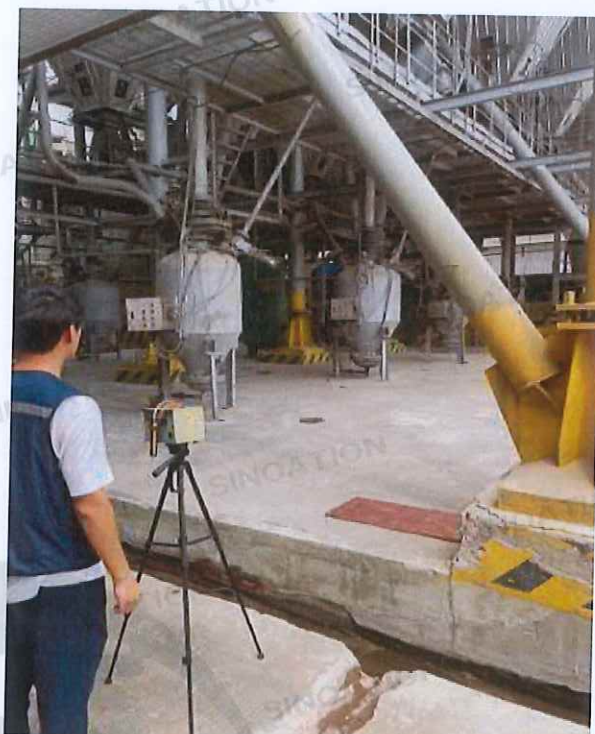
氨区废气下风向监控点 6#
