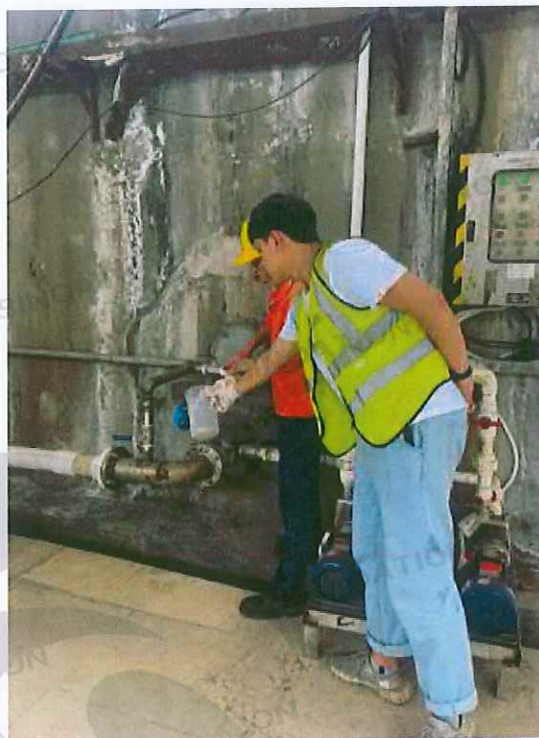
脱硫废水取水点
