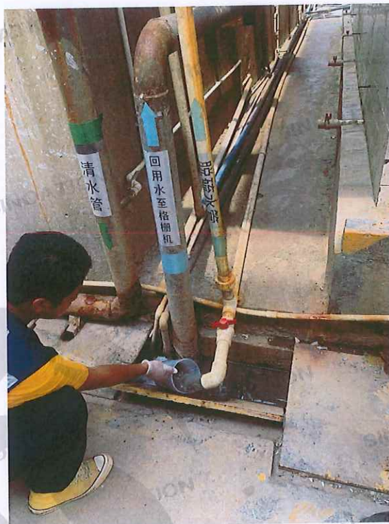
脱硫废水取水点
