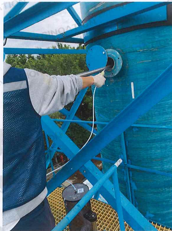
恶臭废气排放口 1#
