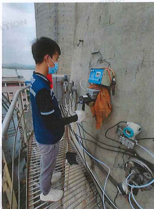
锅炉废气排放口
