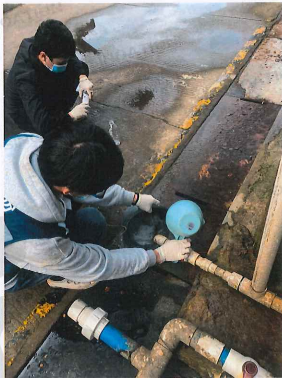
脱硫废水取水点
